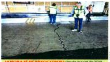
¿AHORA SE PREOCUPAN? Desde marzo de 2019, el nuevo Gobierno de AMLO sabe los serios problemas de hundimientos y daños estructurales de la Terminal 2. PÁGINA 5
