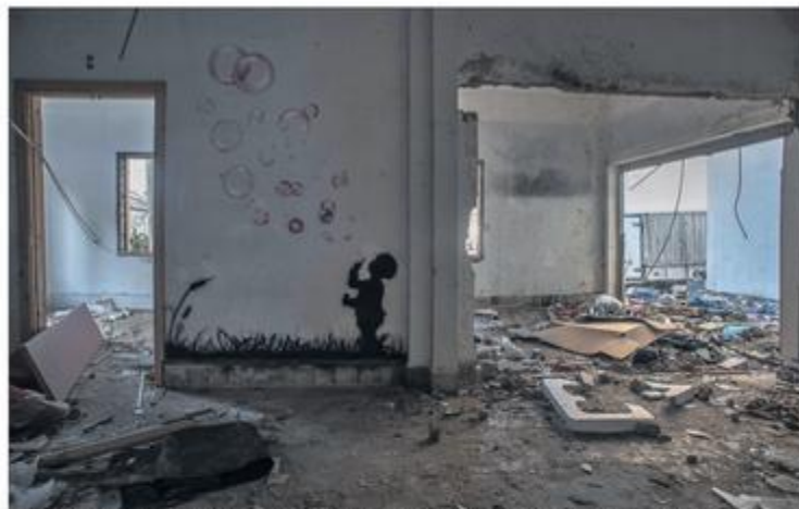
Un grafiti, en una de las pocas paredes que siguen en pie en un edificio abandonado a escasos 200 metros del puerto de Beirut.
